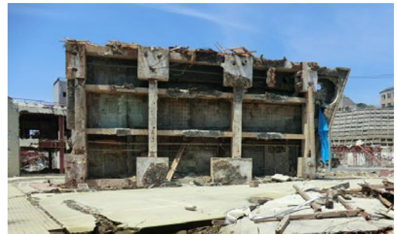
PHC杭がそのまま抜けて、転倒したビル(女川町)
